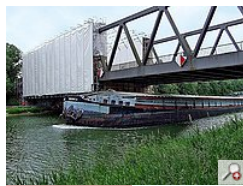
Nur eine Fahrhinne ist derzeit befahrbar | FOTO: KARSTEN SCHULZ
